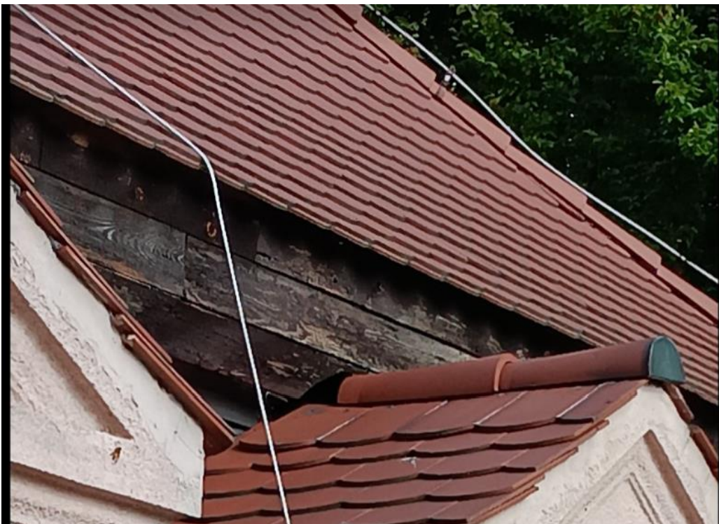
Deskowanie pod okapem dachu wydaje się być pozbawione zabezpieczenia – powierzchnia drewna splukana i wyługowana.
