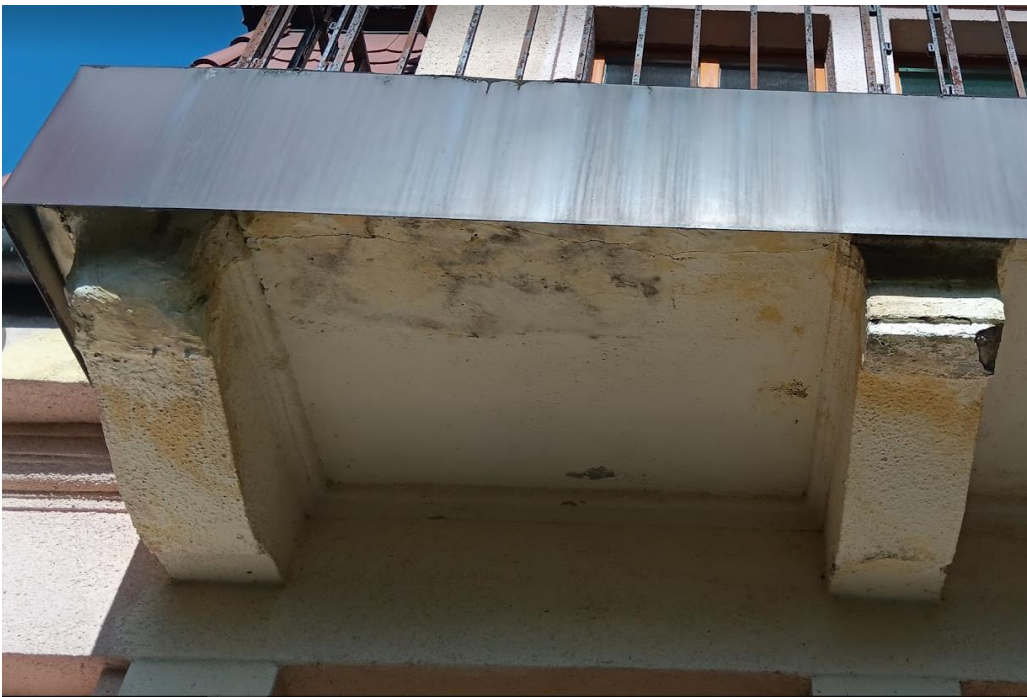
Zawilgocone kroksztyny i płyta balkonu w elewacji południowej
