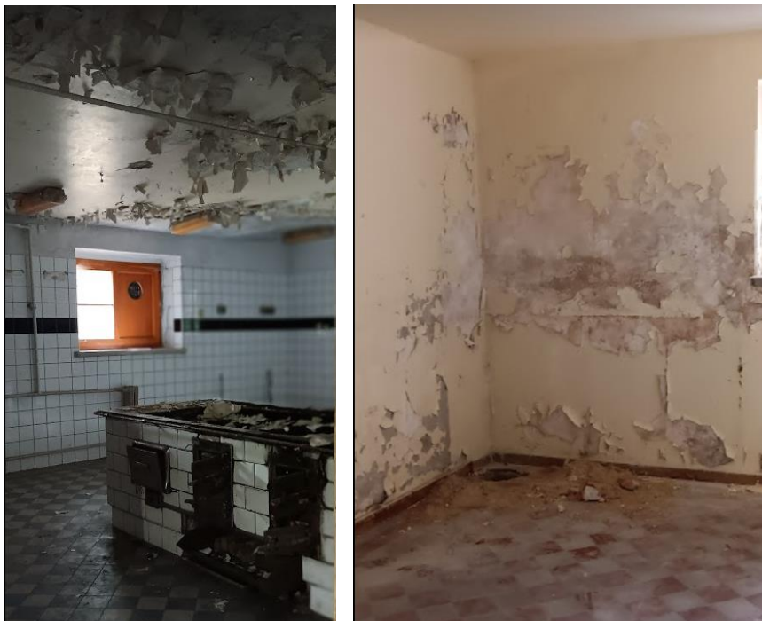
Wnętrza piwnic. Widoczne łuski farby, odpadającej od zawilgoconych tynków sufitu oraz zaplamienia wilgoci i soli na ścianach
