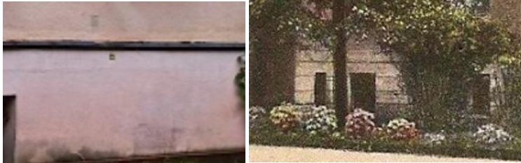
Obecny gładki tynk w partii cokołu oraz historyczna fotografia tej partii ( lata 30 – te XX w)
