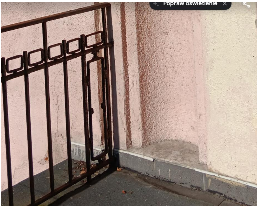
Taras na piętrze – elewacja południowa. Pokrycie z papy – nieprawidłowo ułożone, oraz nieszczelny cokołok z plastikową listwą umożliwiającą wnikanie wilgoci w grubość muru.
