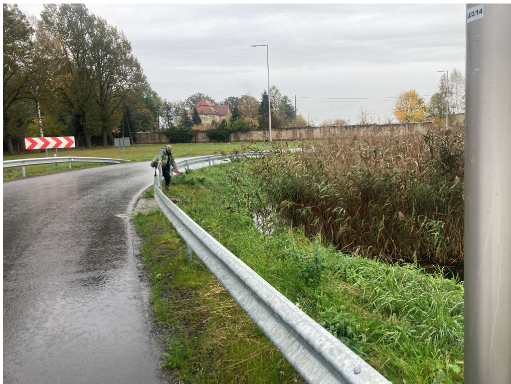
ZDJĘCIE NR 3. BARIERKA ZABEZPIECZAJĄCA STAW.
