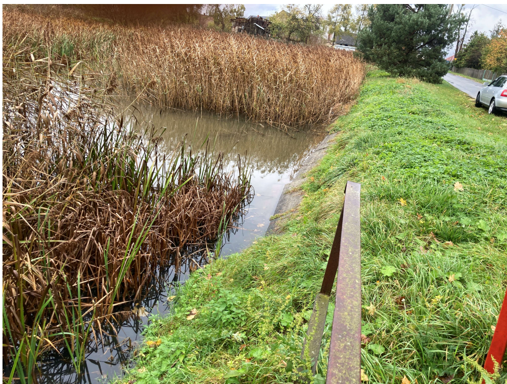
ZDJĘCIE NR 6. ZABEZPIECZENIE MNICHA BARIERKĄ STALOWĄ I UBEZPIECZENIE SKARPY STAWU
