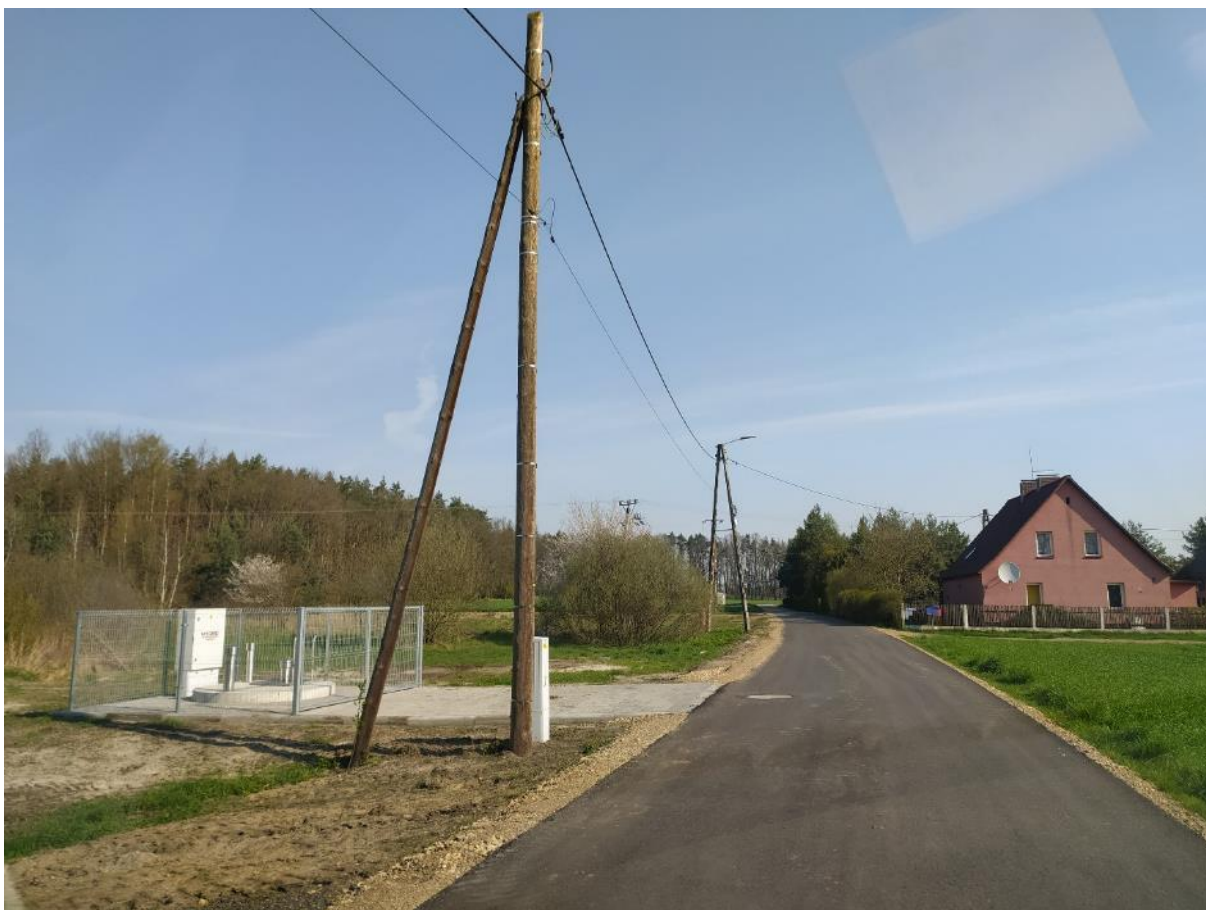
Zdjęcie: Przepompownia przy ul. Młyńskiej w Panoszowie
