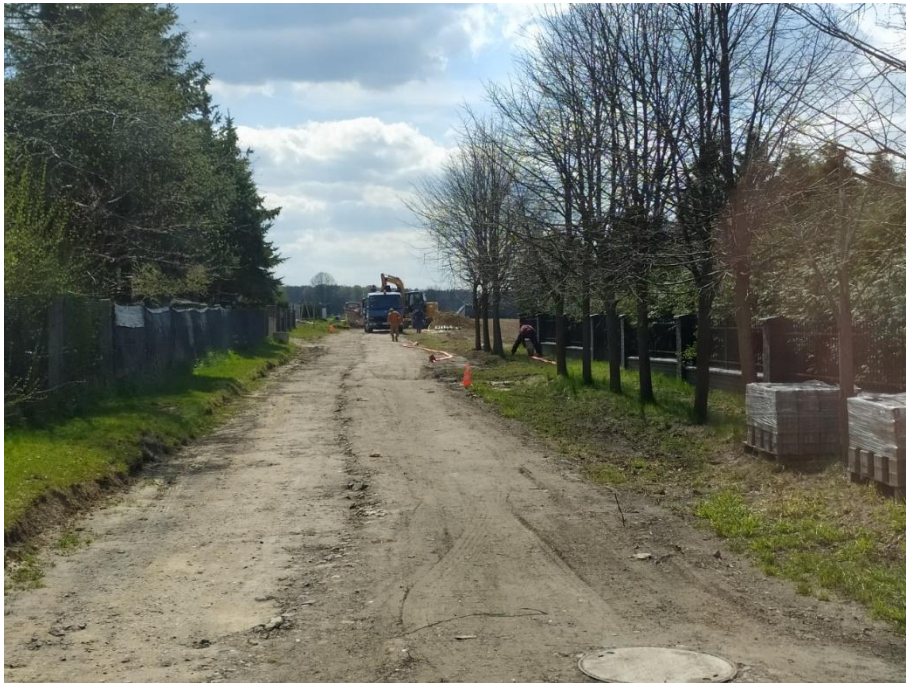
Zdjęcie: Sieraków Śląski ul. Spokojna (pomiędzy ul. Cichą i ul. Spokojną).
