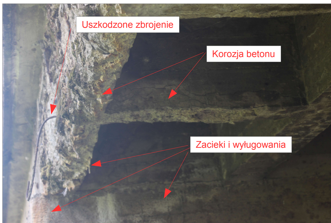
Fot. 6 – Widok na uszkodzony ruszt żelbetowy od spodu konstrukcji
