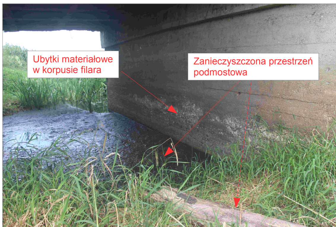
Fot. 4 – Widok na filar i zanieczyszczoną przestrzeń podmostową
