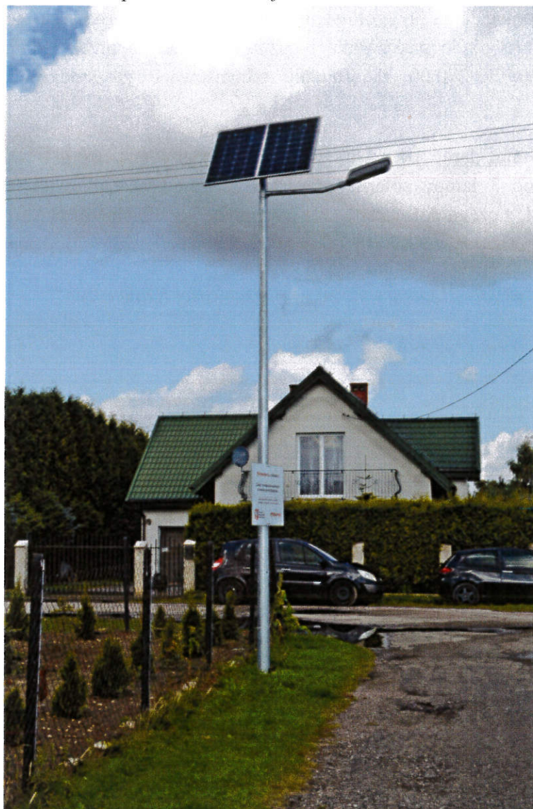
Zdjęcie nr 15 - „Lampa solarna w miejscowości Miszewo Murowane”
