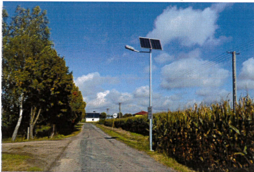
Zdjęcie nr 16 - „Lampa solarna w miejscowości Peplowo”
