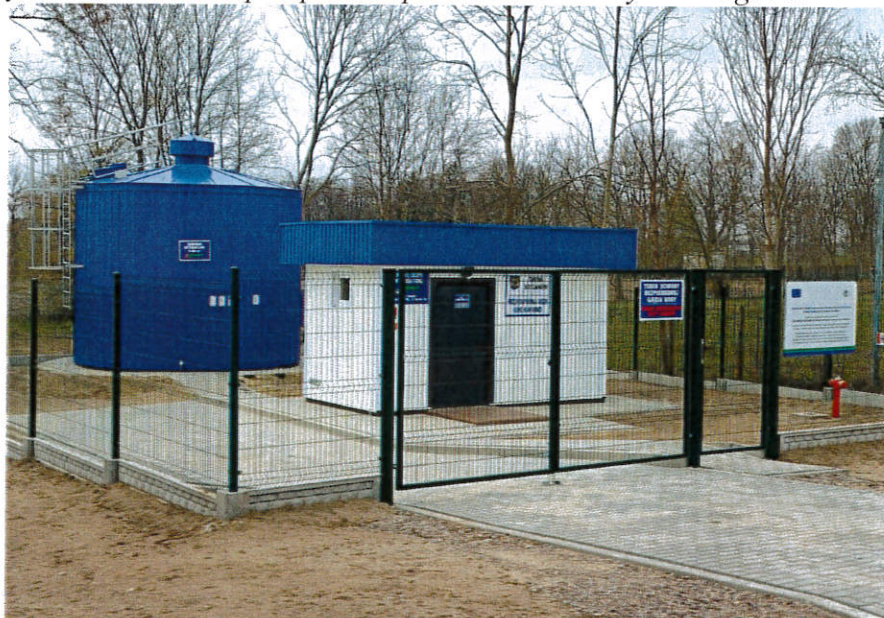
Zdjęcie nr 19 – „Przepompownia pośrednia w Nowym Kanigowie”
