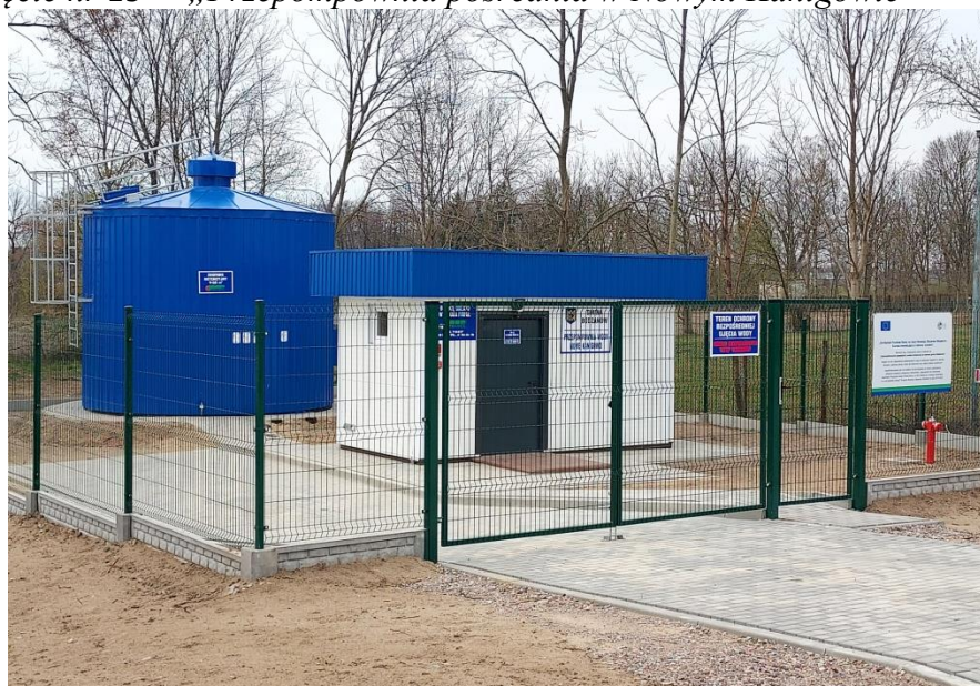
Zdjęcie nr 19 – „Przepompownia pośrednia w Nowym Kanigowie”
