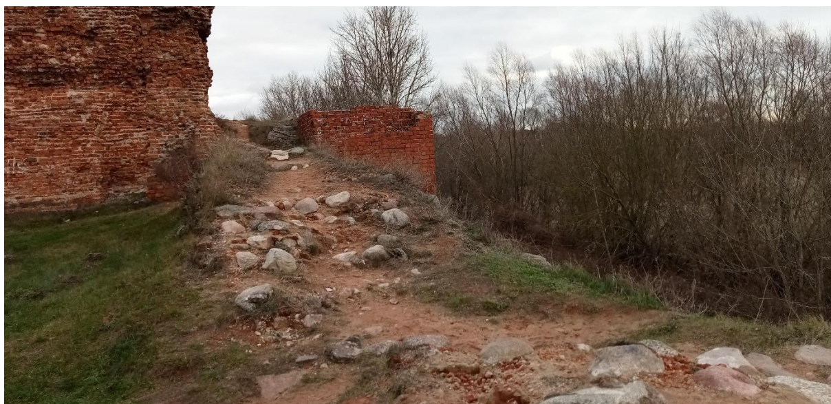
Ryc. 19. Niezabezpieczone ruiny dawnych murów zamkowych
