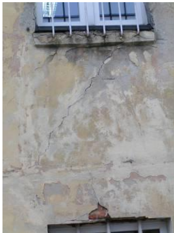
Spękania tynku pomiędzy oknami w elewacji zachodniej. Pęknięcie obejmuje również część parapetu.
