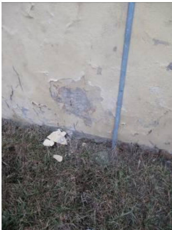
Złuszczona farba oraz odparzony tynk w rejonie cokołu elewacji południowej.
