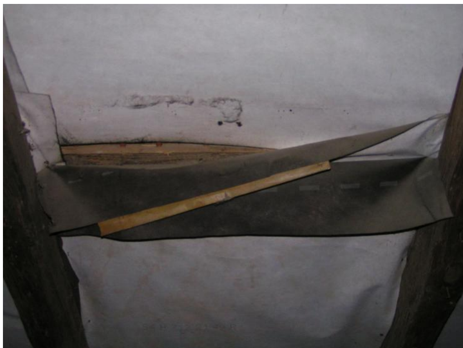
Zdj. 3 Uszkodzona folia dachowa - nieprawidłowy montaż.
