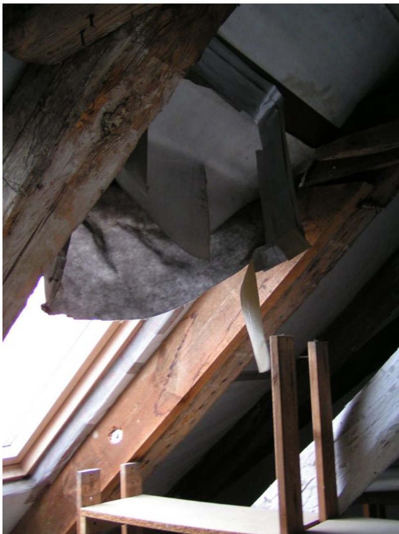
Zdj. 3 Uszkodzona folia dachowa - nieprawidłowe wykonanie obróbki przy oknach dachowych.
