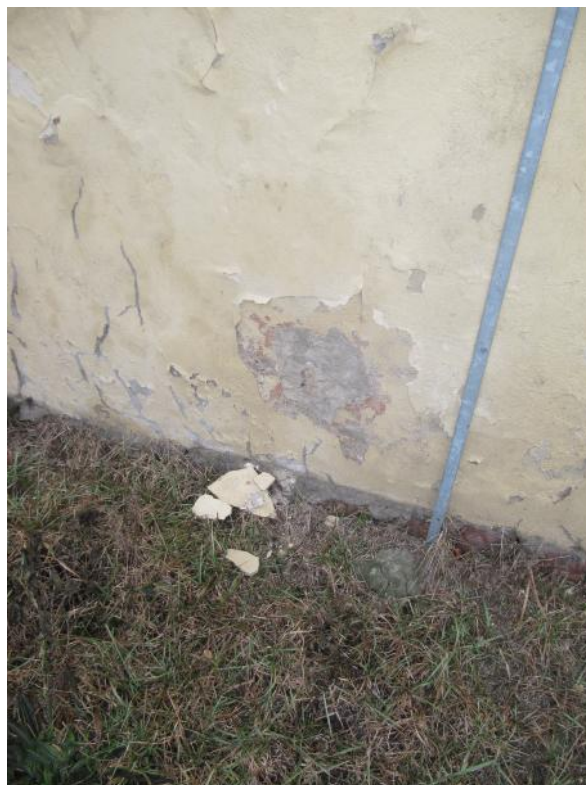
Zdj. 2 Złuszczona farba oraz odparzony tynk w rejonie cokołu elewacji południowej.
